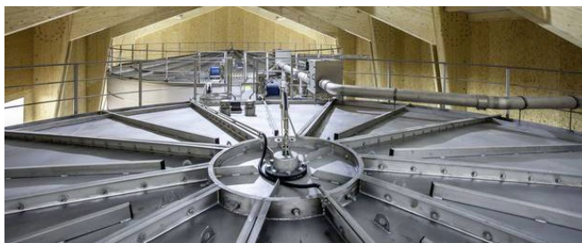
Spiral-welded stainless steel reservoirs erected on site. Source: Bayerische Staatszeitung / Wasserversorgung Bayerischer Wald (Germany), bayerische-staatszeitung.de
